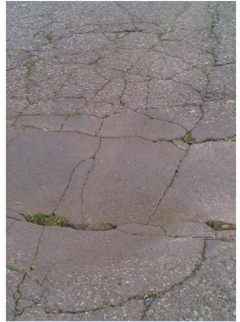
Straßenschäden: Buchenweg Fleestedt
